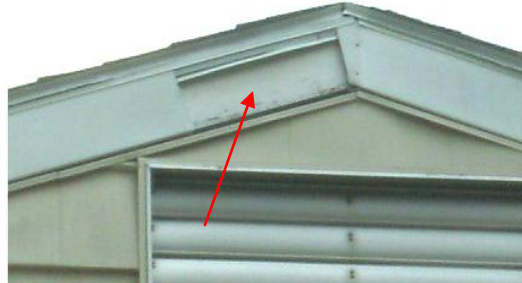
Missing roof edge trim
