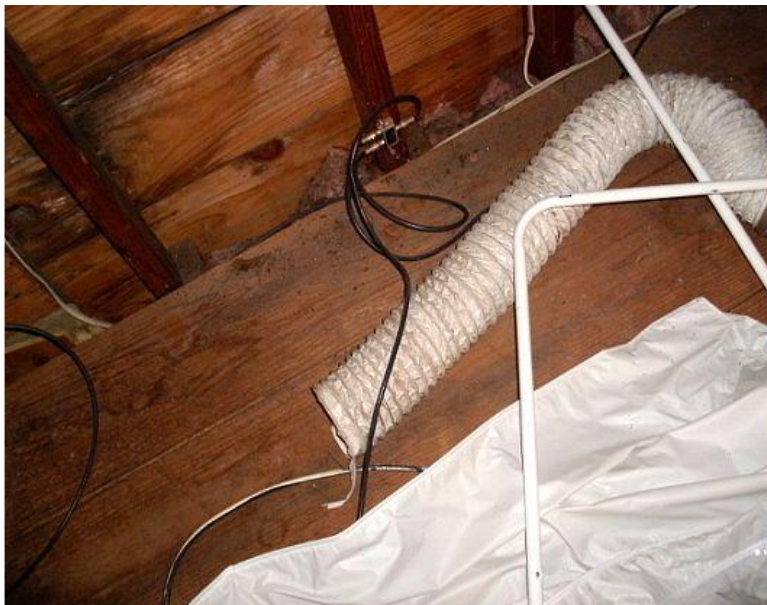
Bathroom vent fan discharge hose
